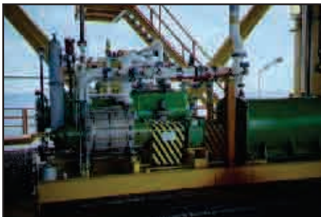
O compressor NASH 2BG utilizado em uma plataforma offshore
