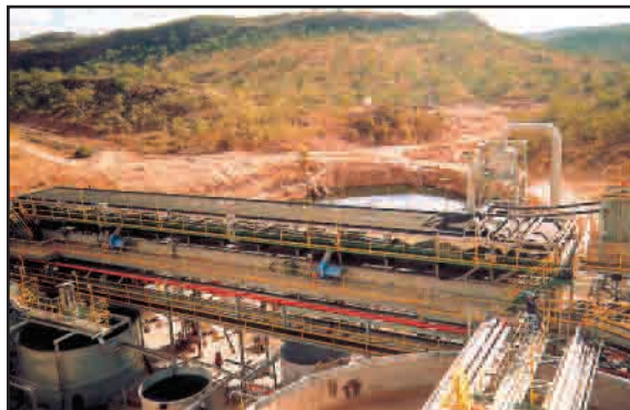
Filtro horizontal tipo correia
